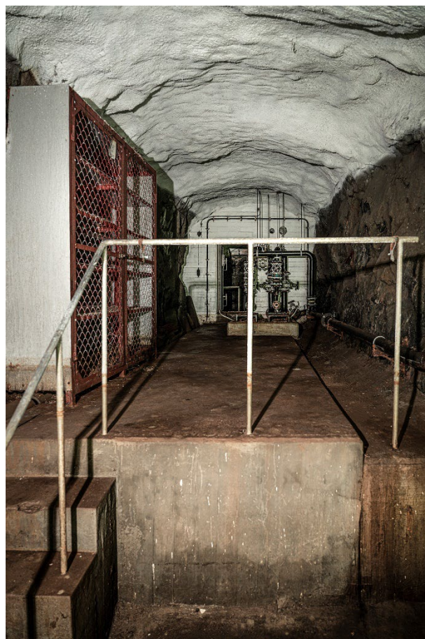
Figur 42. Maskinrum i huvudbunkern med vy mot saltvattenbassängen som var ansluten till avsaltningsanläggning. Vapenskap till vänster. Foto Mattias Brauns.
