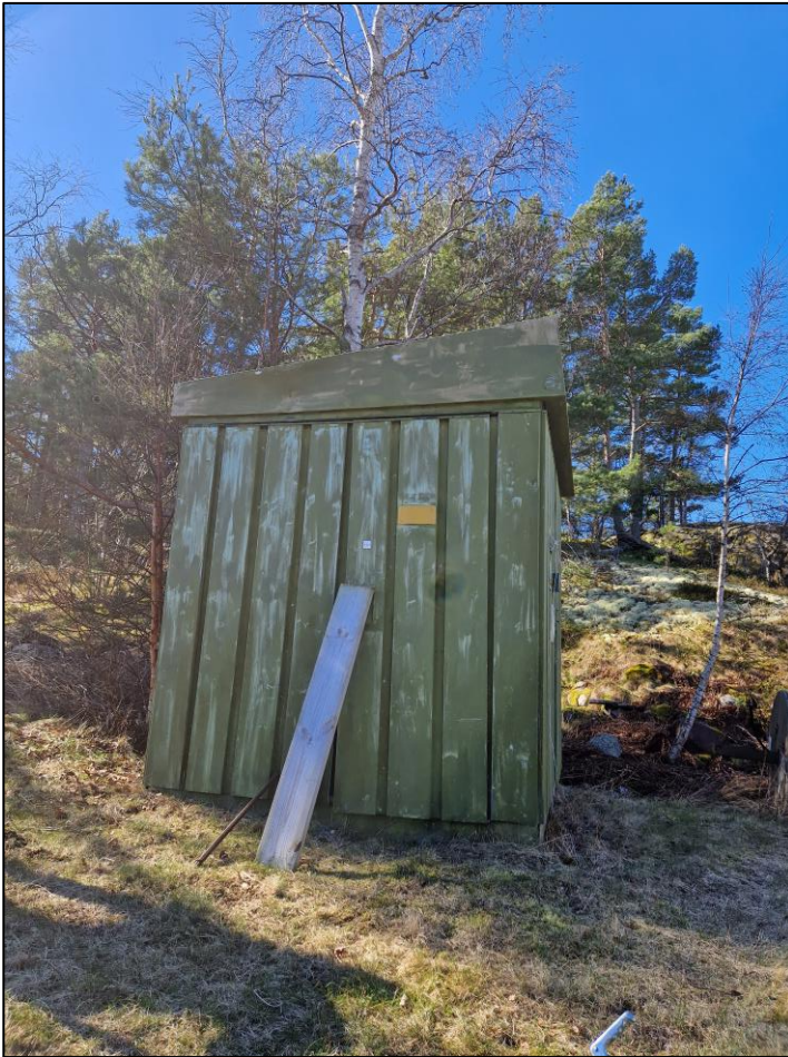
Figur 7. Området runt transformator
