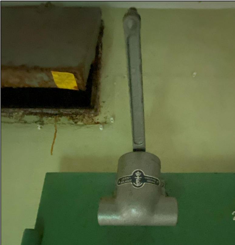
Figur 10. Dörrstängare med misstänkt innehåll av PCB
