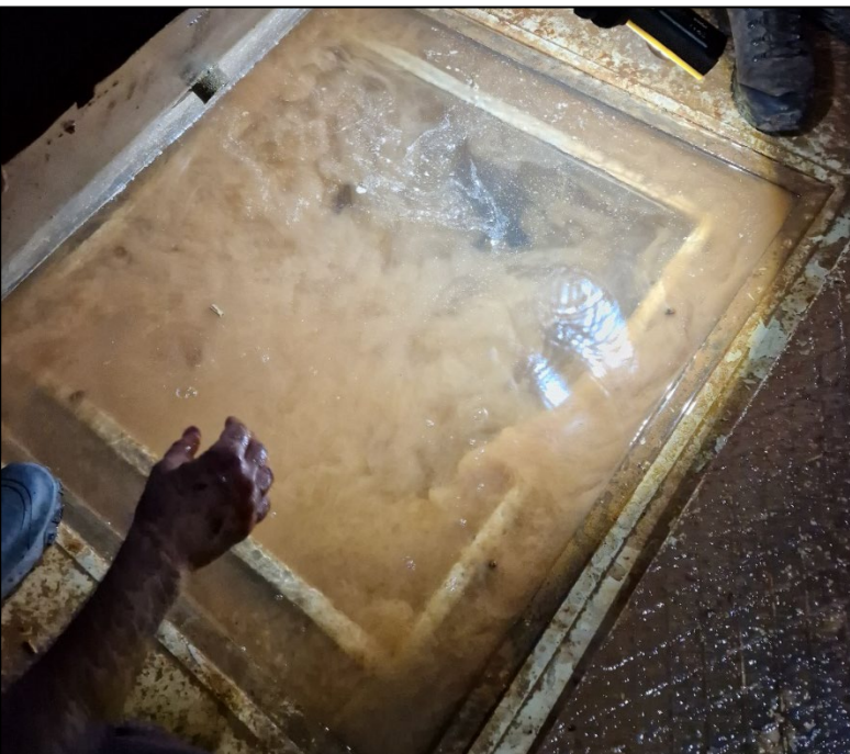
Figur 11. Cisternen på plan minus 4 i huvudbunkern var fylld med vatten och är tömd/sanerad.
