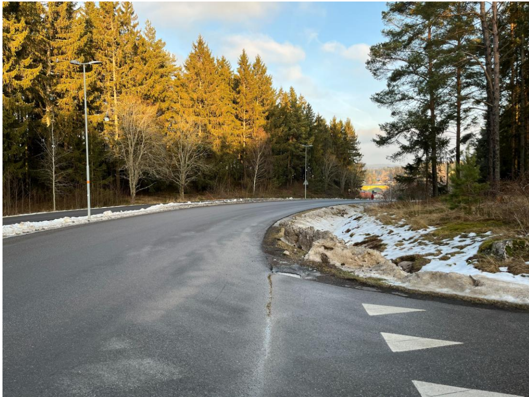
Figur 8 - Dålig sikt i nordöstlig riktning ut från befintlig parkering. Platsbesök 19/1–2026.
