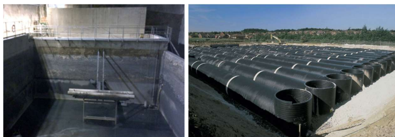
Figur 43. Exempel på platsgjutet avsättningsmagasin (t.v.) samt rörmagasin i plast (t.h.) Källa: Stockholm Vatten och Avfall, Anläggningsbeskrivningar (2025-09-01)
